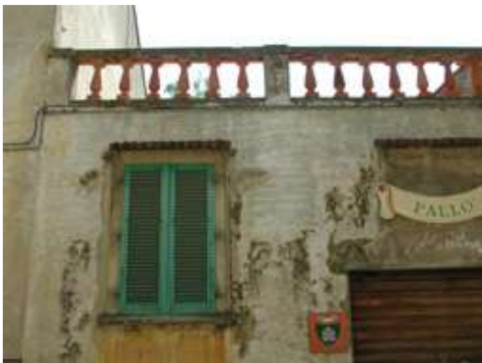
Particolare del prospetto in stato di degrado
